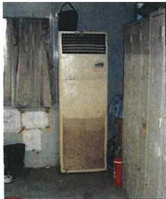
写真 3 : 休憩所に設置したエアコン
